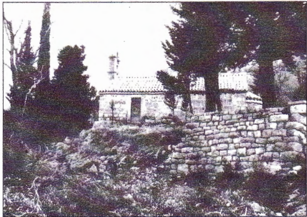
Изглед оштећеног дијела потпорног зида
